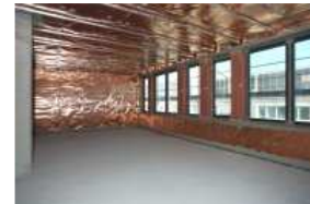
Elektromagnetische Abschirmung von Besprechungsräumen: die Realisierung sollten nur darauf spezialisierte Unternehmen vornehmen. (Bild: Emscreen)
